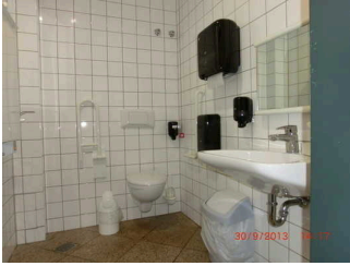
WC mit Haltegriffen in der Lobby
