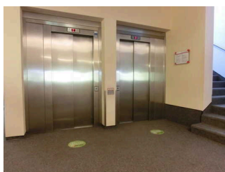
Aufzüge in gleicher Bauart
