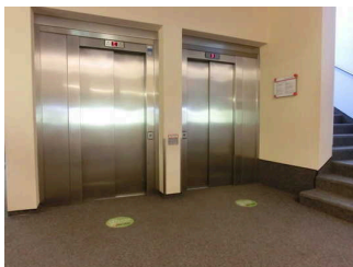
Aufzüge in gleicher Bauart
