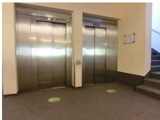
Aufzüge in gleicher Bauart
