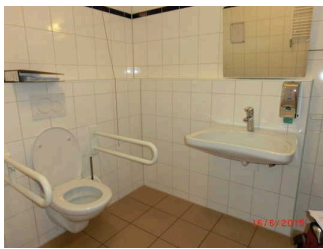
WC und Waschbecken
